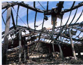
門真配送センター火災
